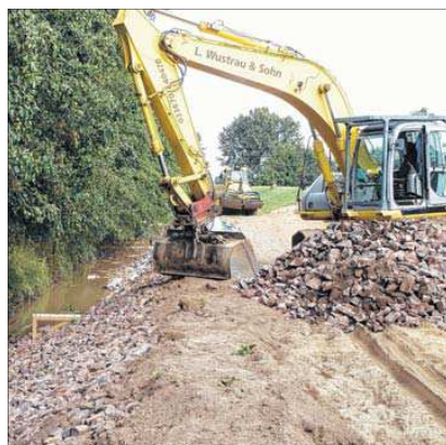
Der Haveldeich bei Molkenberg wurde jetzt zur Gefahrenabwehr besser befestigt. Foto: Ingo Freiherst
