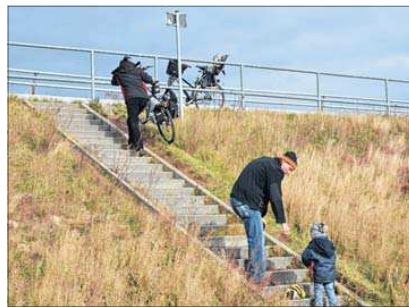
Auch beim Vor-Ort-Termin kamen Radler, welche die Treppe erklimmen und über die Radwegbegrenzung steigen.
