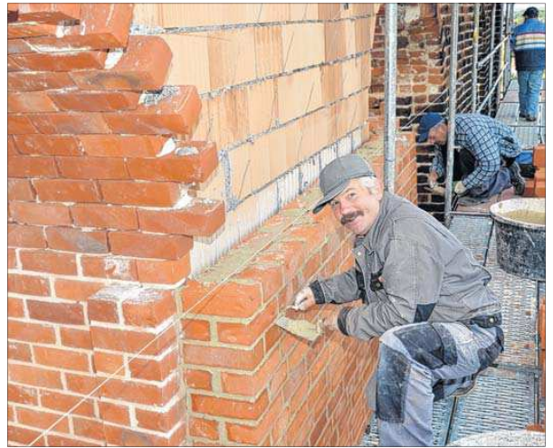
Leander Benkö (vorn) und sein Kollege Heiko Graff verputzen an der Ostseite des Turmes die zuvor von ihnen vermauerten Steine. Foto: Ingo Freihorst
